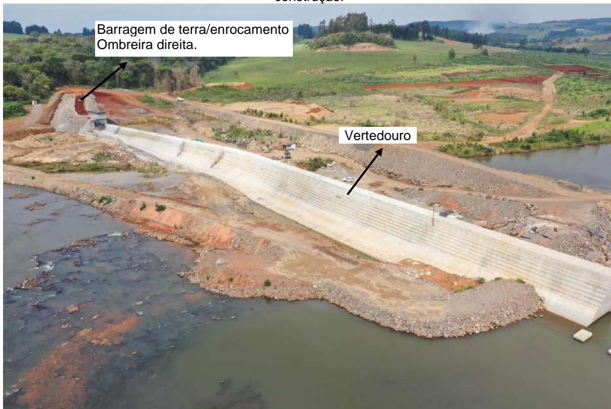
Figura 5 – Fotografia da margem direita e parte do vertedouro da barragem da PCH São Luis em construção.
