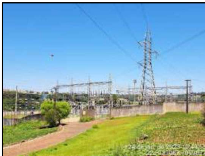
Figura 6 – Linhas de transmissão de alta tensão (230 kV) existentes e entrada da SE Pato Branco.
