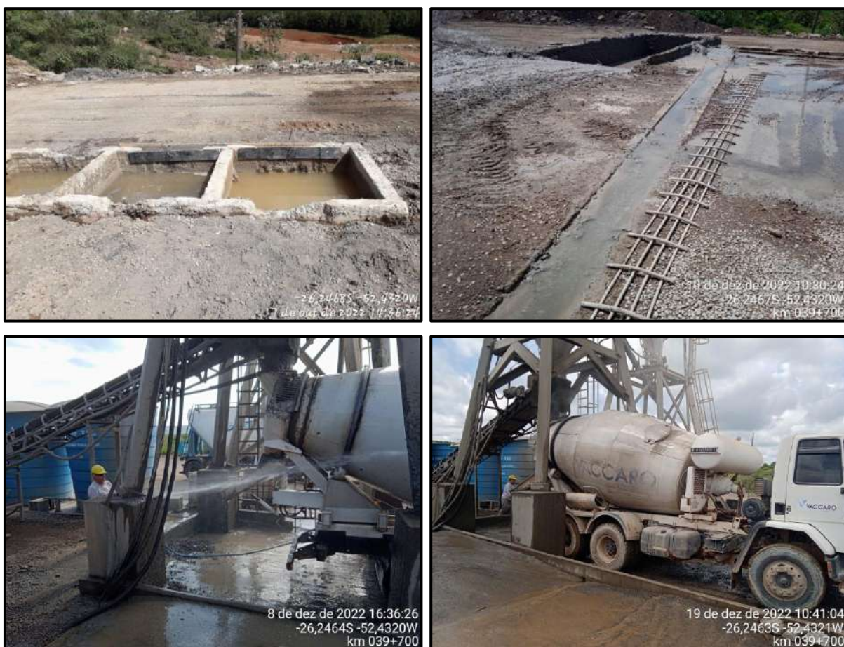
Figura 50 - Estrutura de bate-lastro para limpeza de caminhões-betoneira.
