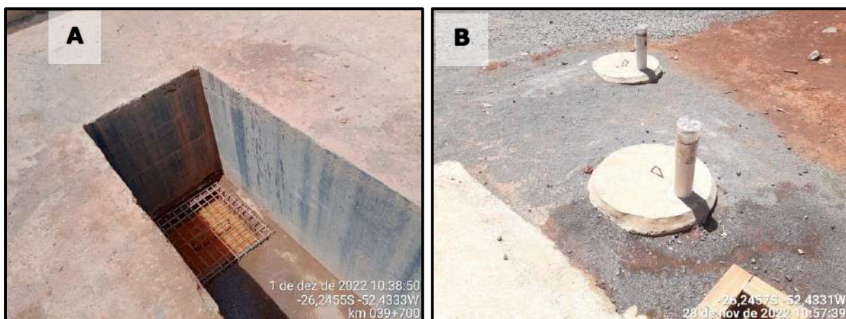
Figura 48 - Registros fotográficos das vistorias realizadas nos sistemas de tratamento de efluentes instalados.
