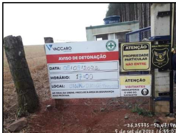
Figura 109 – Placa de aviso de detonação no canteiro de obra.
