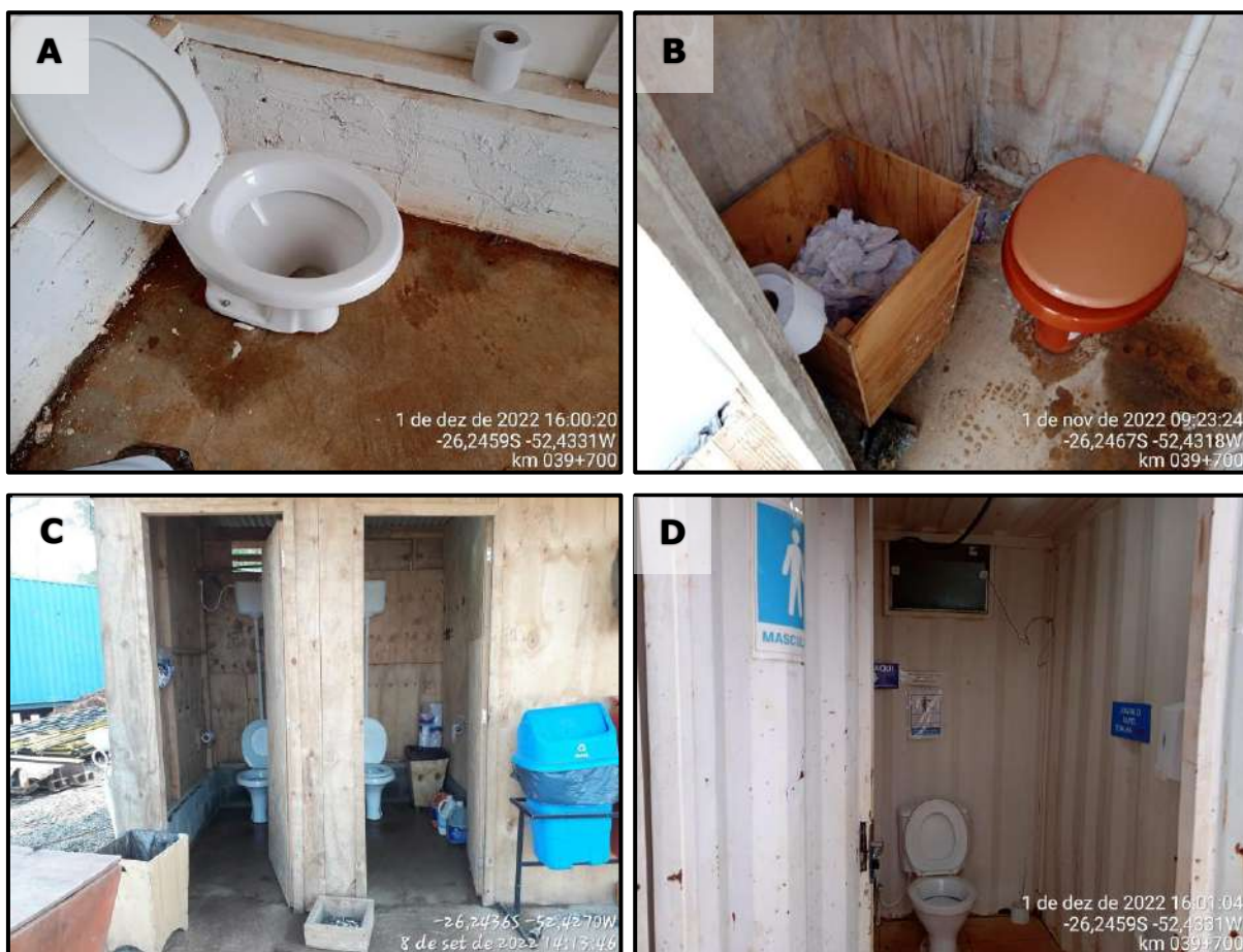
Figura 47 - Registros fotográficos das vistorias realizadas nos banheiros.
