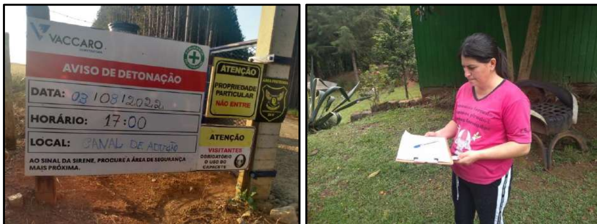
Figura 147 - Visitas à população do entorno da obra para aviso de detonação no canteiro de obras.
