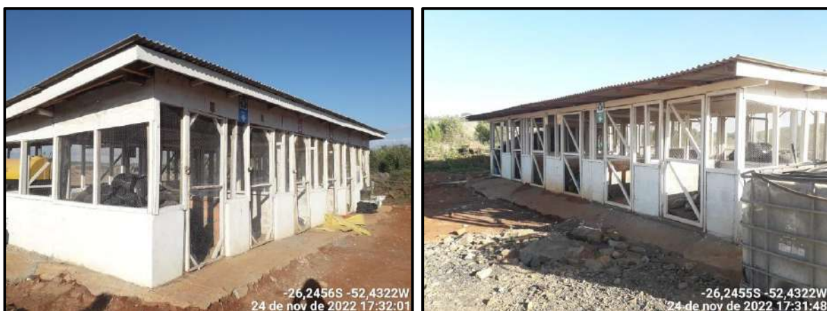
Figura 12 - Acompanhamento das atividades na baia de resíduos.
