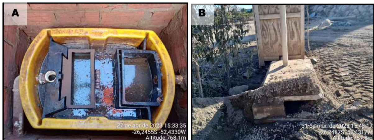
Figura 47 - Registros fotográficos das vistorias realizadas nos sistemas de tratamento de efluentes instalados.
