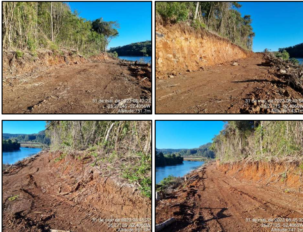
Figura 92 – Locais com oportunidades de melhoria do programa de estabilidade de taludes marginais.
