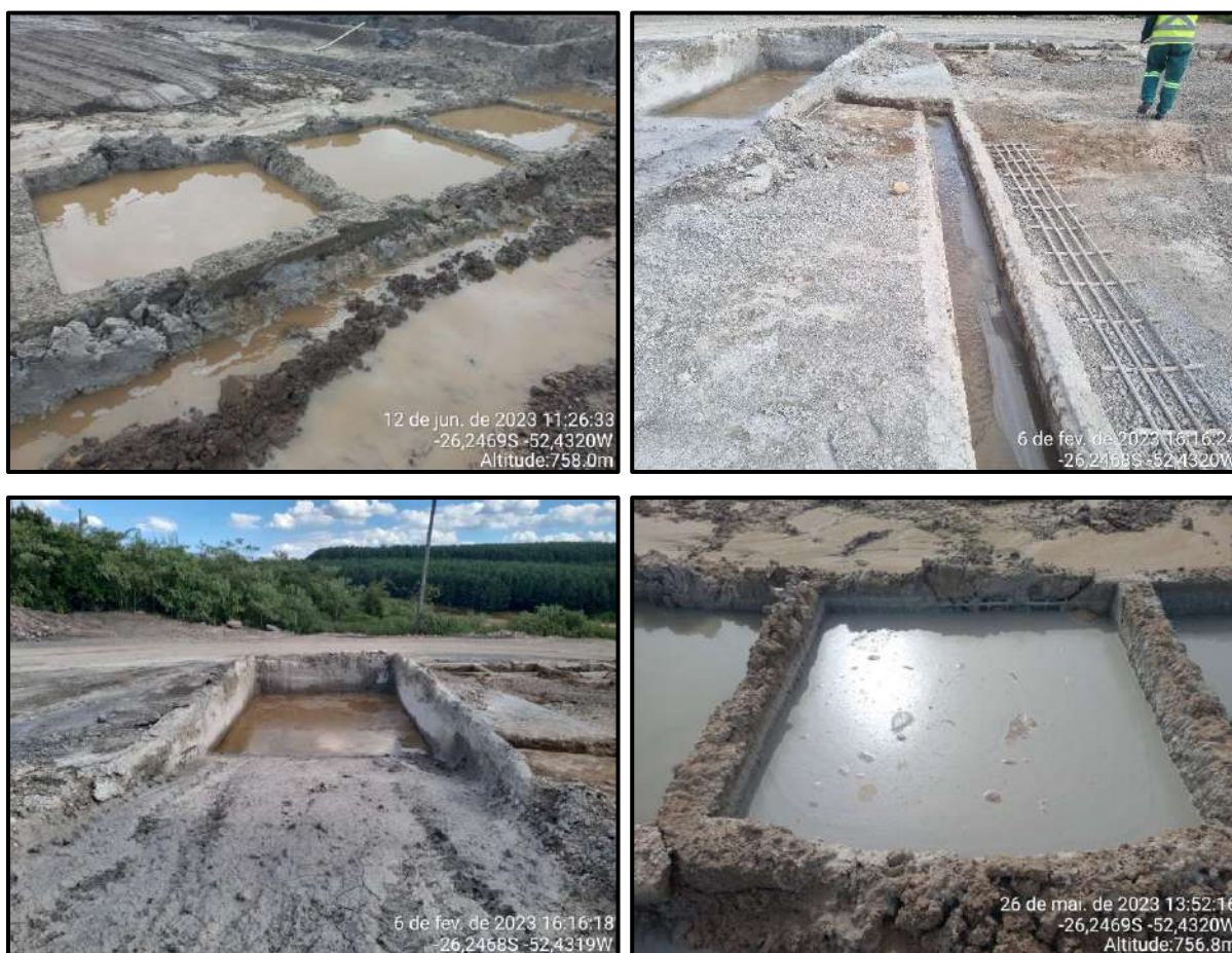
Figura 51 - Estrutura de bate-lastro para limpeza de caminhões-betoneira.
