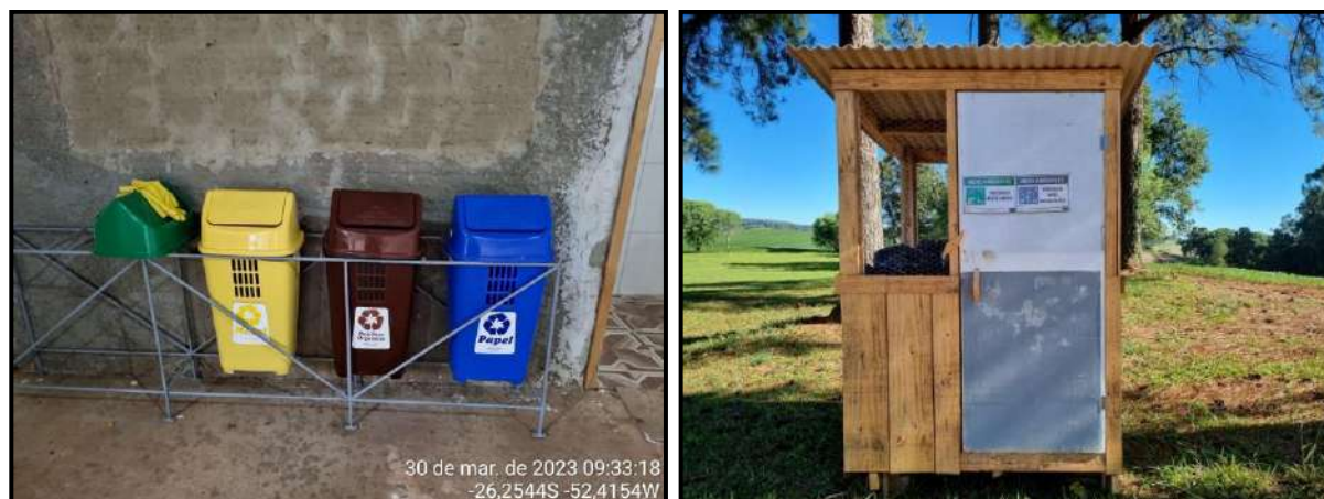
Figura 31 - Instalação dos kit's de coletores de resíduos e nova baia de acondicionamento de resíduos orgânicos
