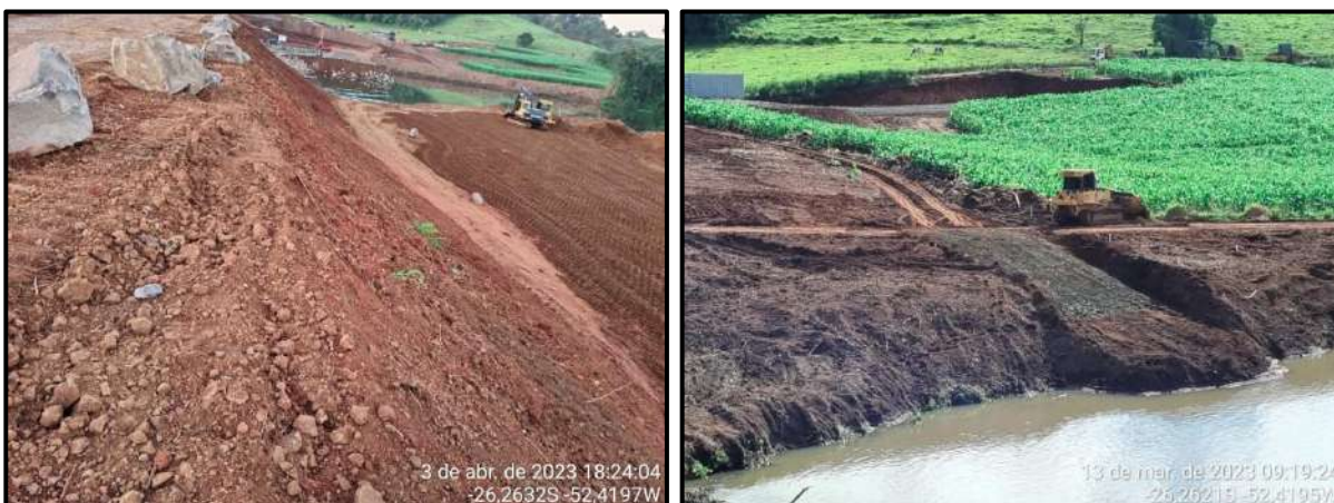
Figura 58 – Monitoramento de processos erosivos na área de construção da nova ponte sobre o Rio Chopim.
