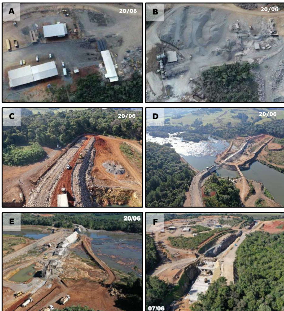
Figura 2 - Registros fotográficos do canteiro de obras e estruturas da PCH São Luís.
