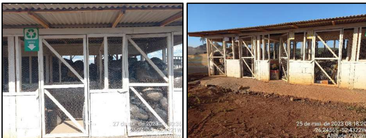
Figura 27 - Registros fotográficos das baias de resíduos sólidos da PCH São Luís.
